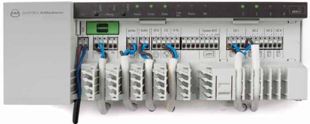
Kuva 69. Selkeät kytkentäyksikön tilailmoitukset ja yksinkertainen sekä turvallinen käyttölaitteiden erillislaitteisiin kytkentä.
